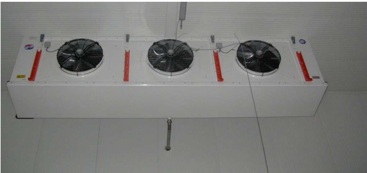
Foto 2 – Particolare aerorefrigerante a 3 ventilatori
