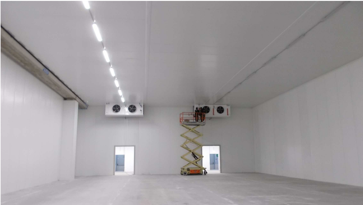
Foto1 – Cella N° 4 BT zona “A”- sullo sfondo i due aerorefrigeranti presenti in corrispondenza delle porte
